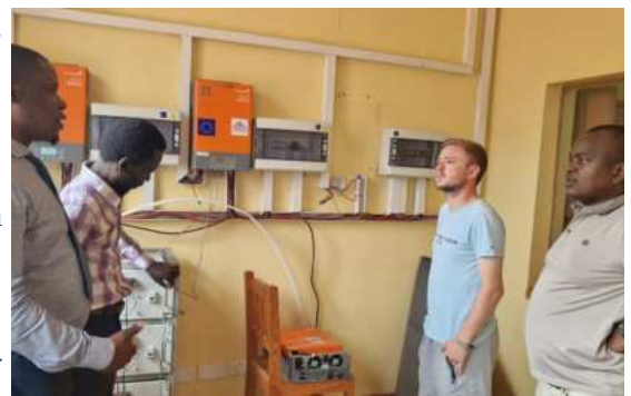
Menard und Tim vor einer Solaranlage
